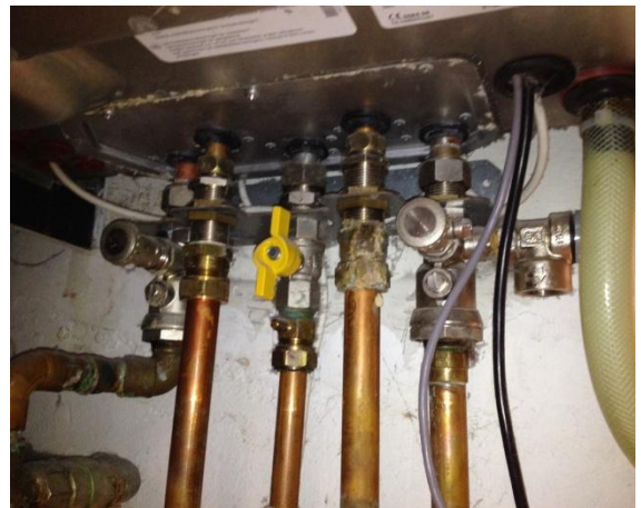
| Mindre tæring på varmerør.
