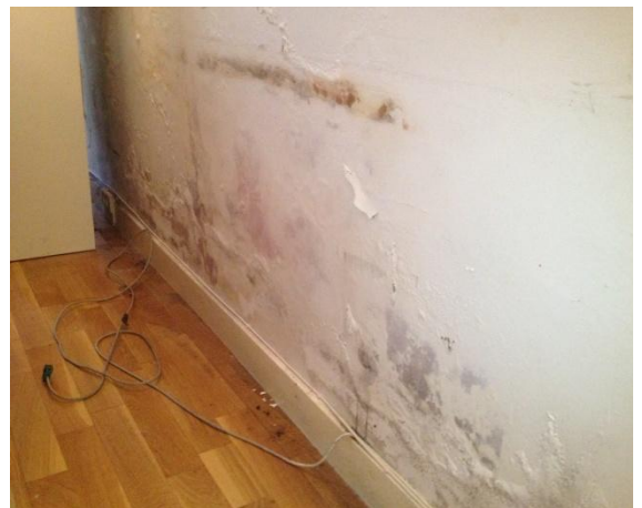
| Væggen lider meget af fugtproblemer og skimmelvækst.
