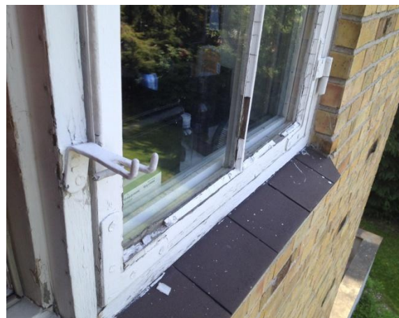
På de "varme facader" trænger vinduerne og altandørene en del, og skal udbedres hurtigst muligt.
