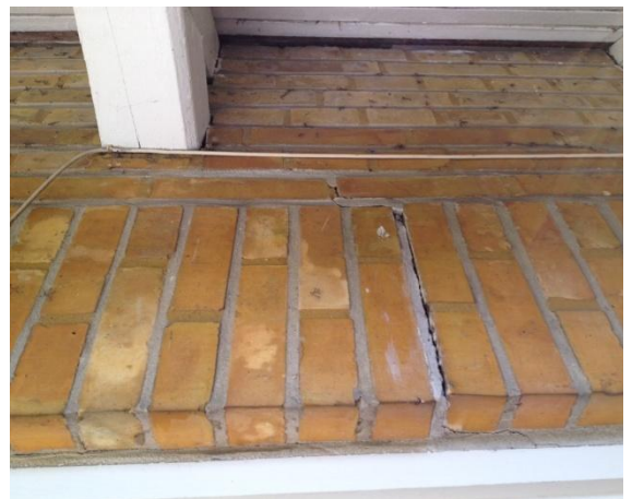
Revne over fransk altandør
