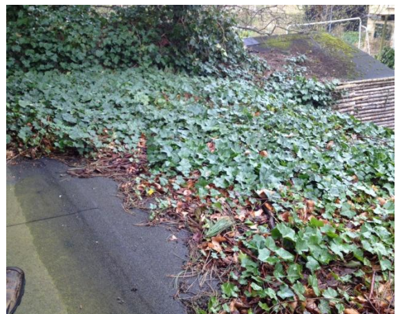
| Det er vigtigt at der ikke ligger for meget skidt og møg, og planter som holder skidt, da det påvirker afvandingen af taget.
