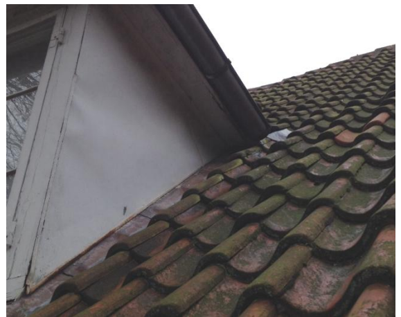
| Gavlen her er oplagt at få efterisoleret, bemærk jembjælken øverst.
