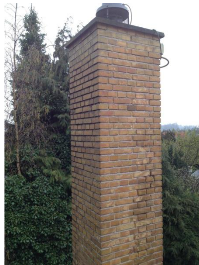
| Skorstenen set fra oven, skadet fuger.
