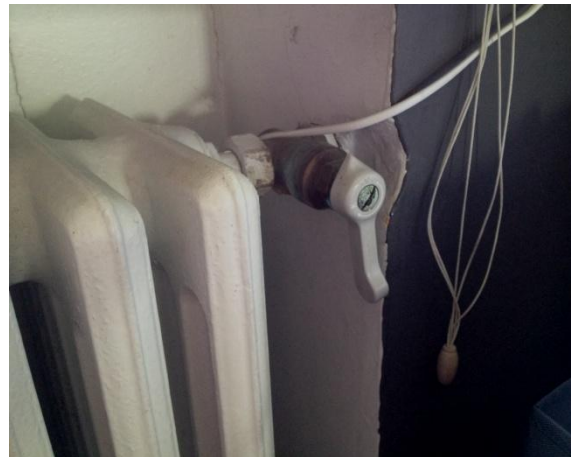
| Denne ventil regulerer ikke ind efter rumtemperaturen, hvilket giver energispild.
