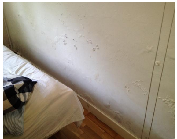
| Bagved sengen ses der voldsomme "udbrud" af løs puds og maling.
