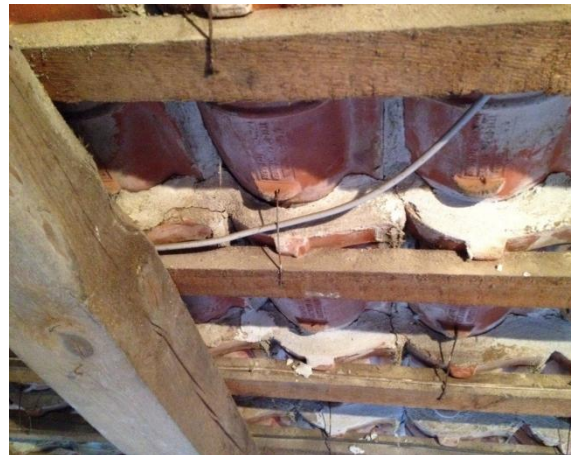
Understrygningen er meget vigtig at holde løbende øje med.
