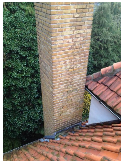
| Udfaldne fuger, ses særligt i bunden.
