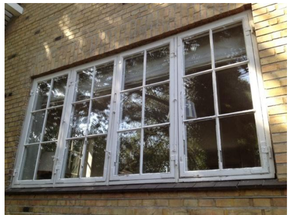
På de "kølige " facader er vinduerne i rigtig fin stand.
